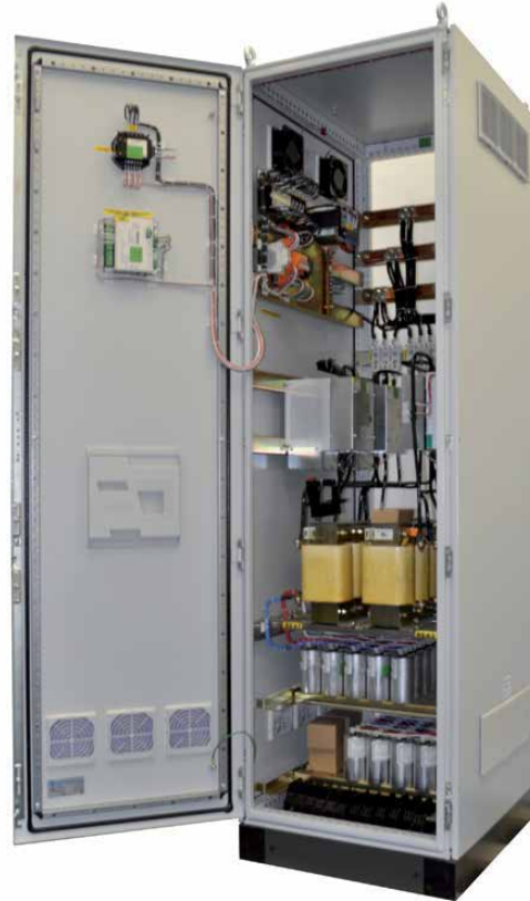
› Figura 2.10. Banco de Capacitores Automático en BT
