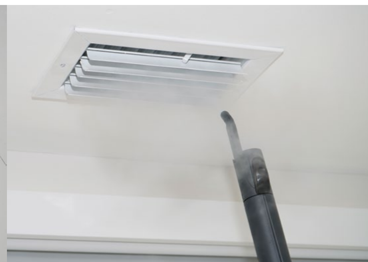
Ductos del Aire Acondicionado o Calentador
