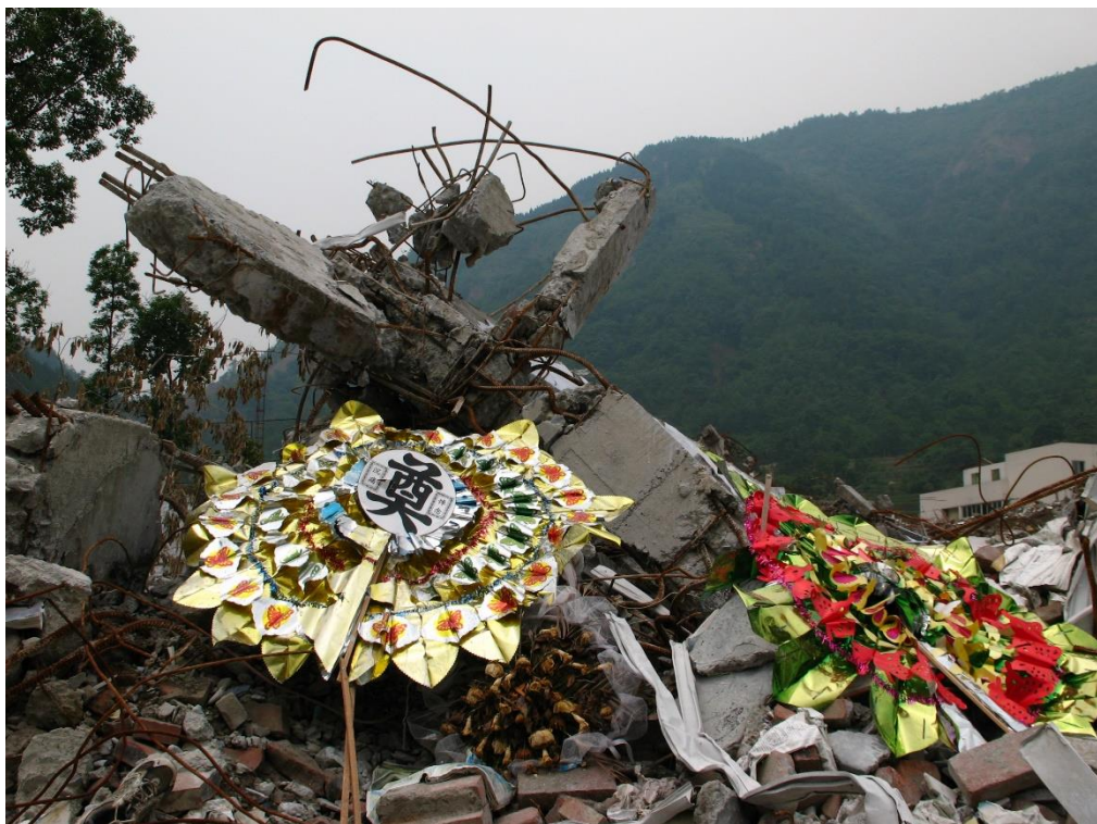
北川中学教学楼废墟
