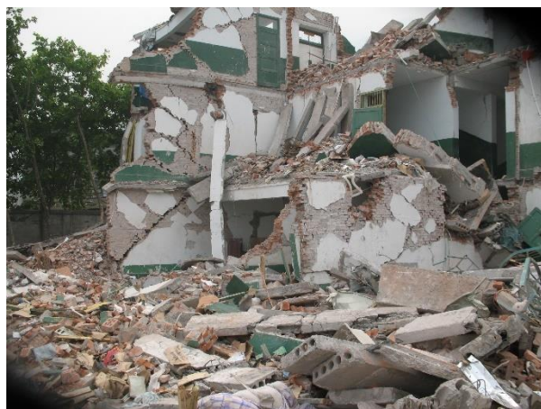
垮塌的汉旺小学教学楼
