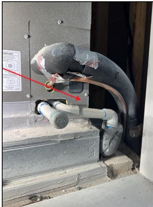
47. No float switch
