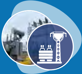
SUB-ESTACIONES ELÉCTRICAS LINES DE ALTA Y BAJA TENSIÓN
