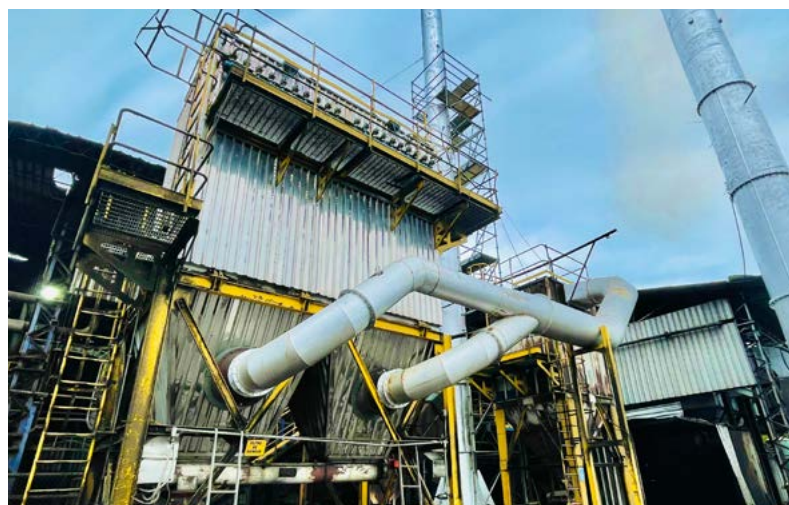
Sistema de ductos de salida de gases Extractora palmas del Sur de Casanare
