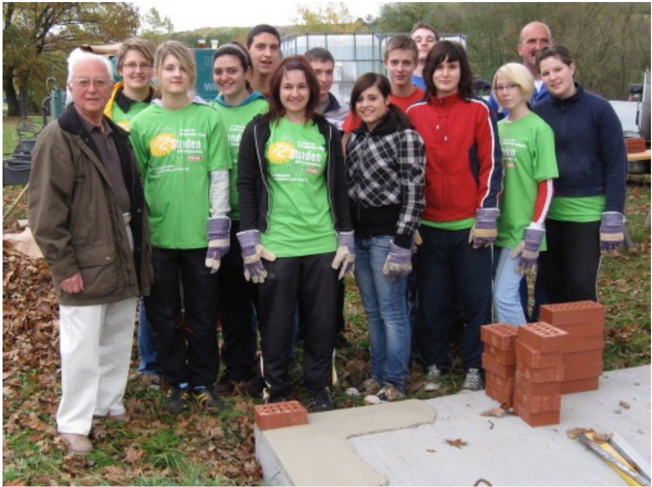
21. Der erste Ziegelstein ist gelegt. Das Team eifriger junger Leute ist bereit für das 72-Stunden-Projekt, der Bau des Friedensmahnmals.
