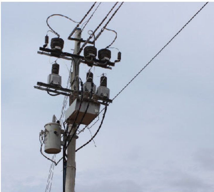
Red de distribución de energía
