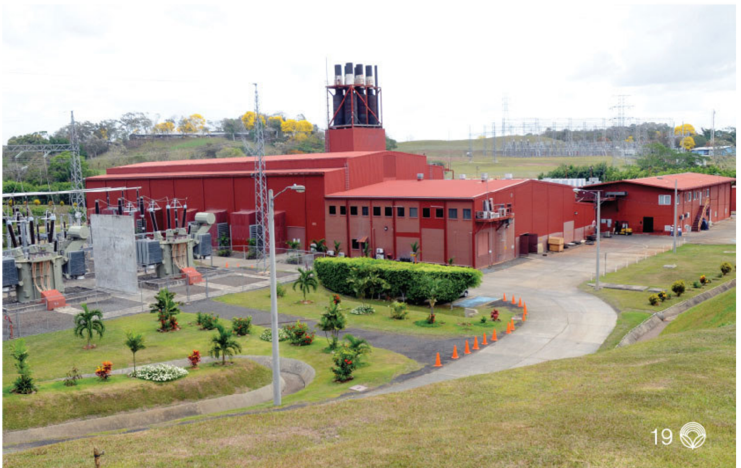
Planta Pan Am Generating Ltd.
