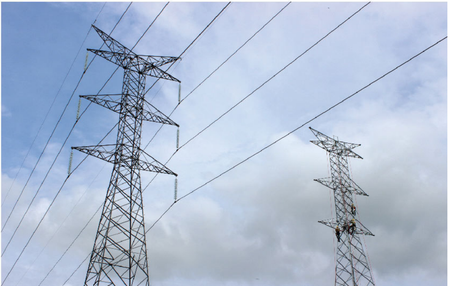
Tercera línea de transmisión eléctrica
