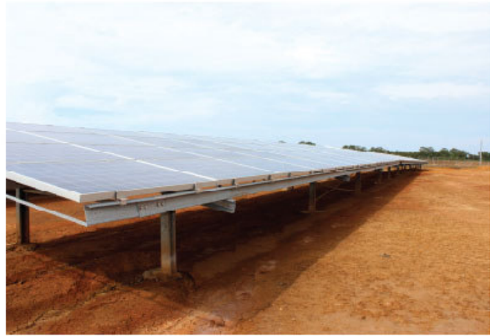
Planta Fotovoltaica Sarigua
