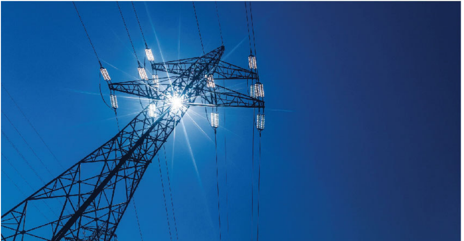
Torre de alta Tensión
