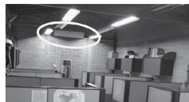
Foto 3. Unidad de Aire Acondicionado en la oficina de Gestión Ambiental
