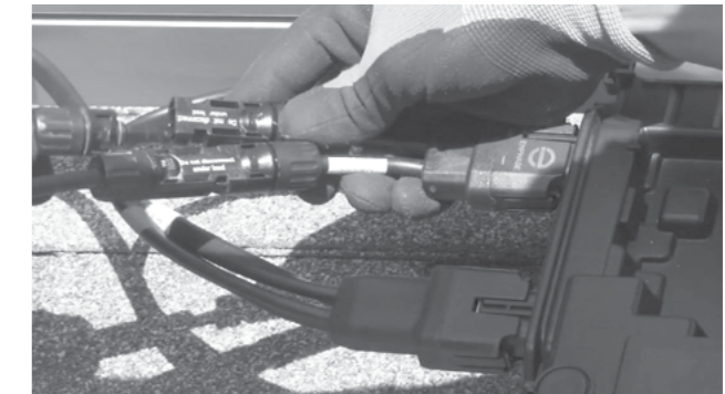
Foto 17. Cables de entrada y salida de un microinversor Fuente: (Enphase, 2020)
