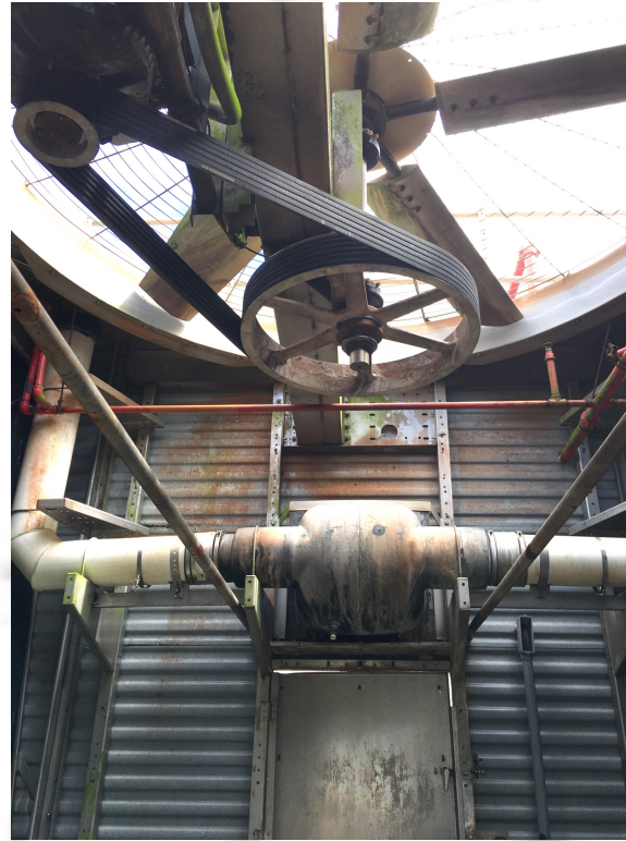
Cooling Tower Fan
