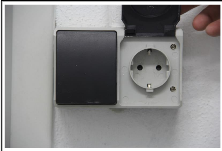
Enchufe e interruptor (interior sub-entidad)
