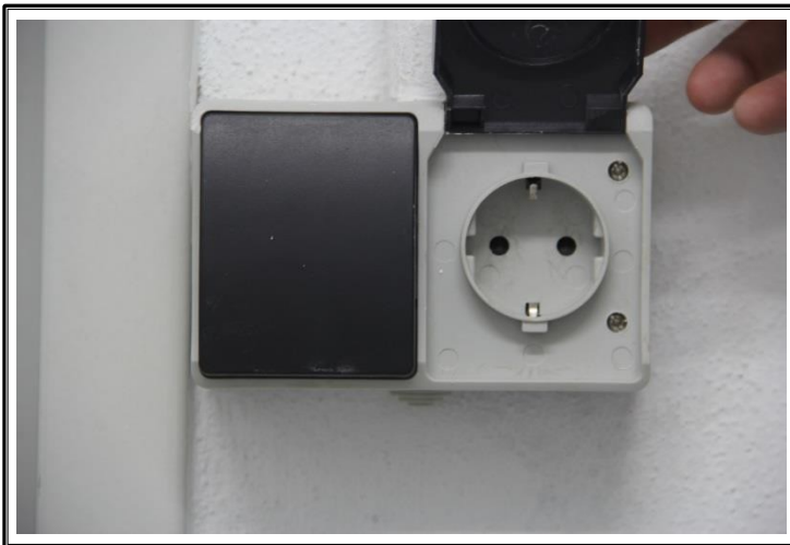
Enchufe e interruptor (interior sub-entidad)
