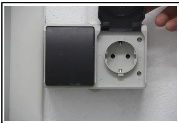
Enchufe e interruptor (interior sub-entidad)
