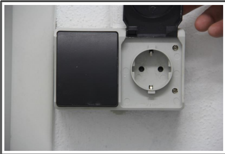
Enchufe e interruptor (interior sub-entidad)
