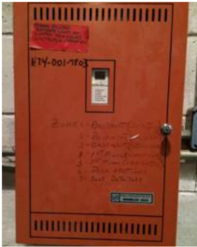
E13 _Fire Alarm Panel
