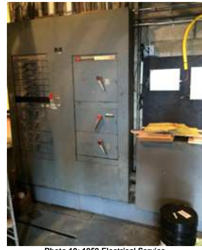
E10 _Electrical Service-1959
