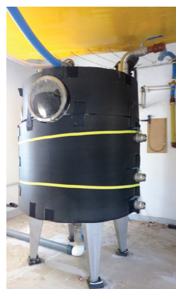
Biodigestor de la Planta Experimental de Biogás de la Facultad de Ciencias Agrarias - UNCuyo.
