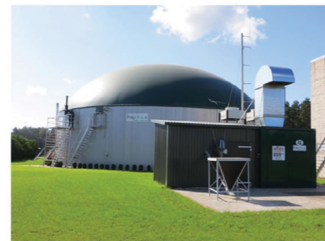
Planta de biogás en los países bálticos Sustrato: Estiércol porcino y residuos de matadero. Capacidad eléctrica: 190 kW
