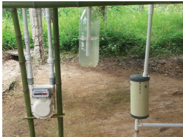
Medición de flujo de biogás.
