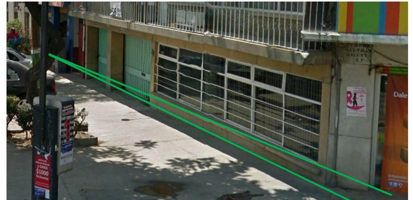
Ilustración 24. Edificación con más de 80 cm de hundimientos (Eje central y cumbres)
