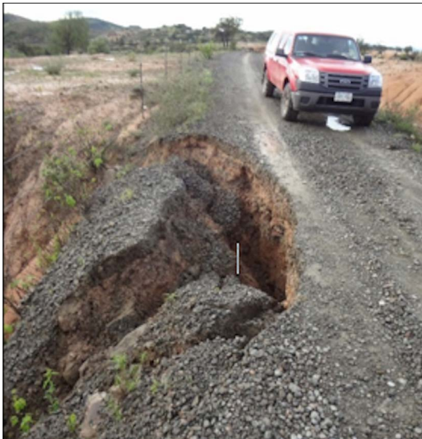
Figura 1. Daños en el camino del Geosendero Los Corazones, por erosión y movimientos en masa debido a lluvias torrenciales en el GMUMA.
