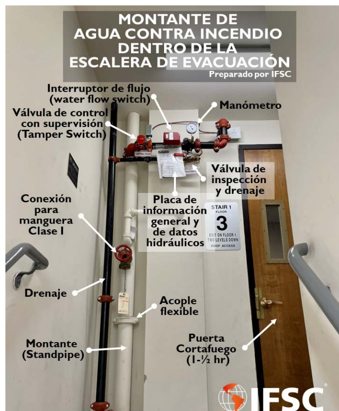
Unidad de control de los rociadores, con conexión Clase I para mangueras dentro de la escalera
