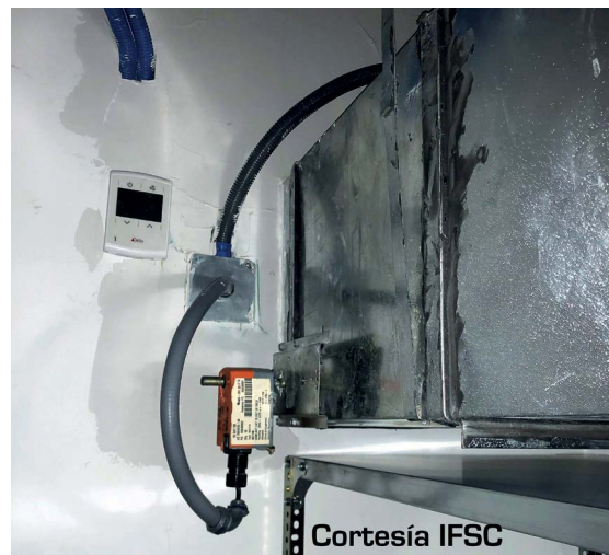
Compuerta corta humo en un ducto de aire traspasando una pared corta humo
