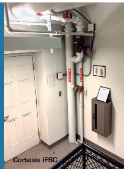
Foto 1. Sistema combinado, donde el montante dentro de la escalera supe al sistema de rociadores y al Sistema Clase I
