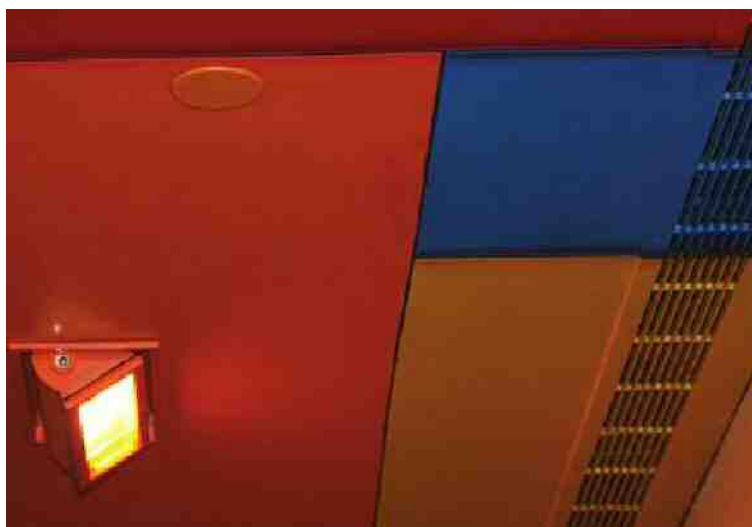
Rociador tipo escondido pintado del mismo color del techo
