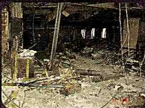
5:47pm-Vista desde un piso incendiado, donde se detecta una fuerte desviación de las vigas
