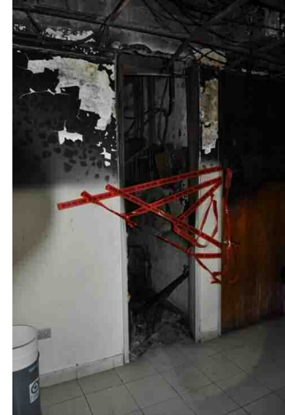
Puerta de acceso al cuarto eléctrico en el 4º Piso
