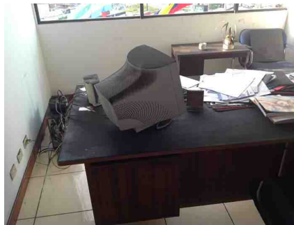
Daño por humo en las oficinas
