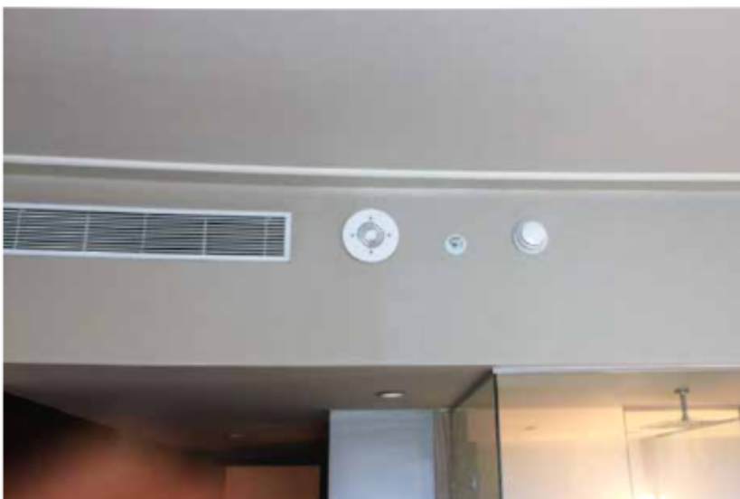
PROTECCIÓN EN UNA HABITACIÓN: PARLANTE, ROCIADOR DE PARED Y ALARMA DE HUMO (FOTO CORTESÍA IFSC).
