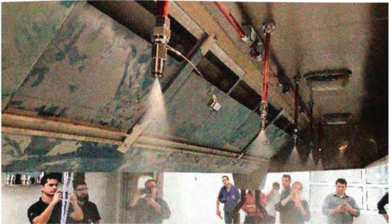
PRUEBA DE ACEPTACIÓN DE UN SISTEMA DE SUPRESIÓN A BASE DE QUÍMICOS HÚMEDOS (WET CHEMICALS) PARA CAMPANAS DE COCINAS (FOTO CORTESÍA IFSC).
