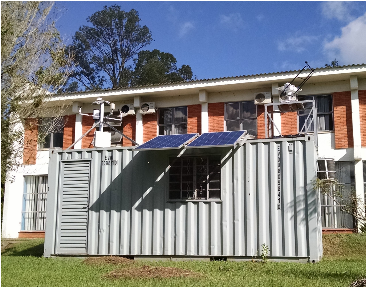
Figura 25. Estação de radiometria solar da UERGS, unidade Porto Alegre. Esta estação realiza medidas das componentes direta, difusa e global da radiação solar além da obtenção de outros parâmetros meteorológicos. A estação opera de modo autônomo da rede elétrica e disponibiliza todos os dados coletados em tempo real.
