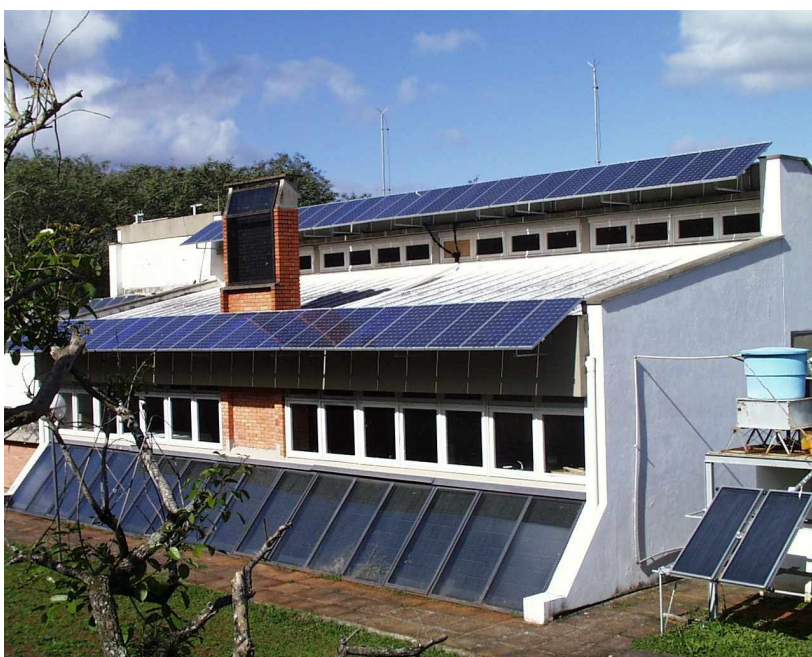
Figura 5. Prédio do Laboratório de Energia Solar, LABSOL, da UFRGS onde podem ser visto os módulos fotovoltaicos que integram o sistema conectado à rede de 4,8 kWp implantado no ano de 2004. Fonte: LABSOL, UFRGS.
