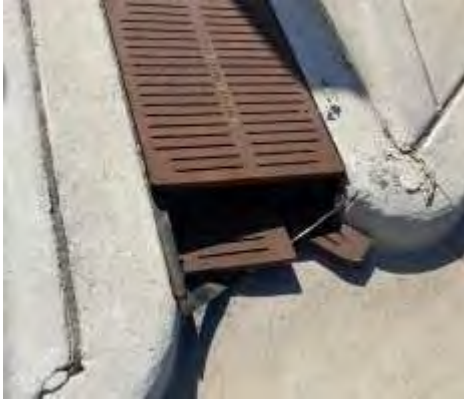
09.12.22 Broken grate Main/3 rd S
