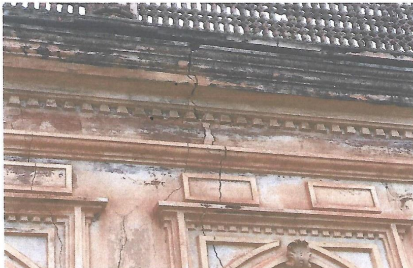
FISSURAS NA FACHADA FRONTAL
