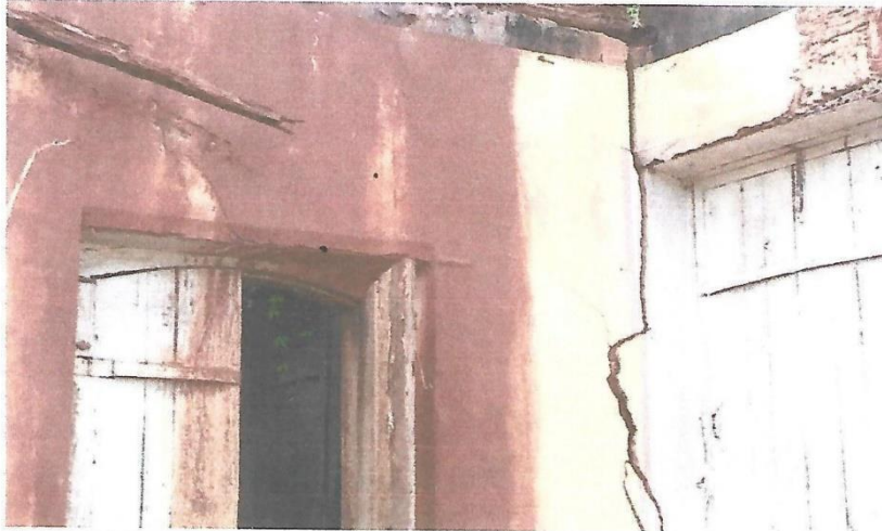
PAREDE INTERNA COM FISSURA EVIDENTE
