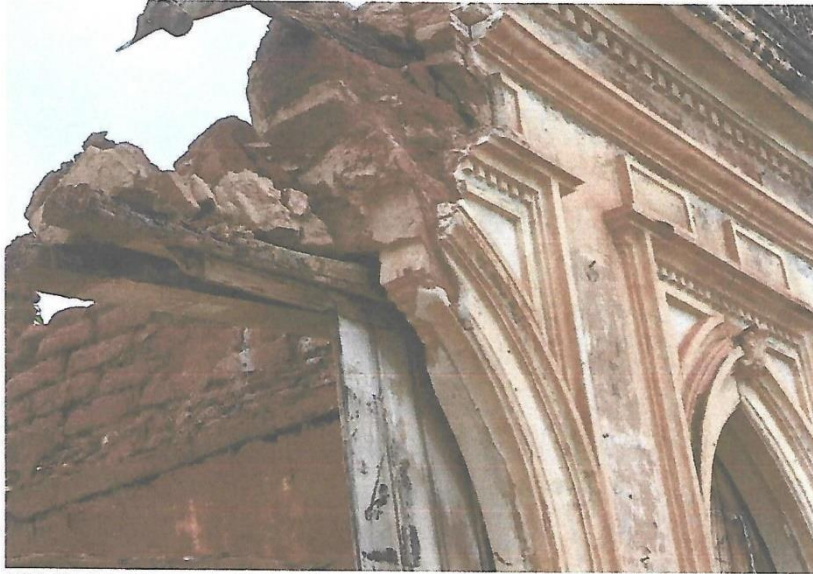
TRECHO DA FACHADA FRONTAL DESMORONADA
