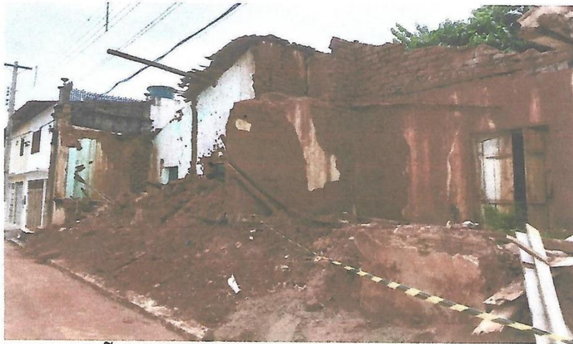
RUA JOÃO PESSOA- PAREDE DESMORONADA
