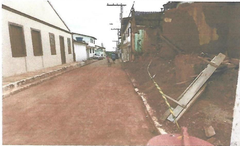
PAREDE LATERAL ESQUERDA- DESMORONOU NA RUA JOÃO PESSOA
