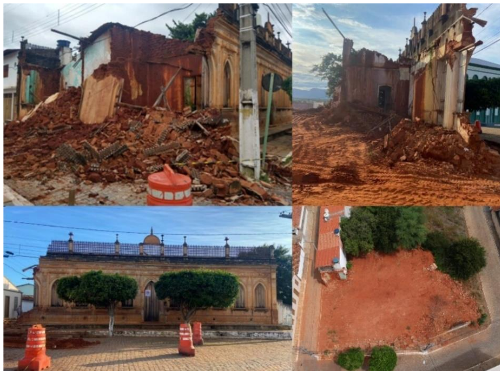
Figura 14 – Painel do processo de demolição do Casarão Alcântara, dezembro de 2021 a fevereiro de 2022
