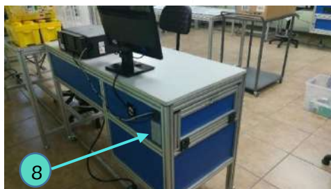
Fig. 46 Contacto Eléctrico a 110 VCA
