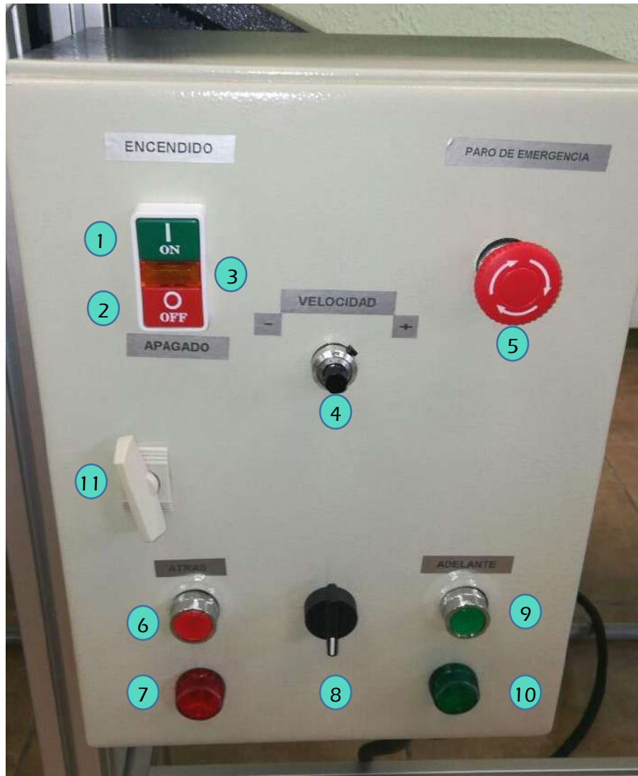
Fig. 77 Tablero de control de bandas transportadoras de almacenes
