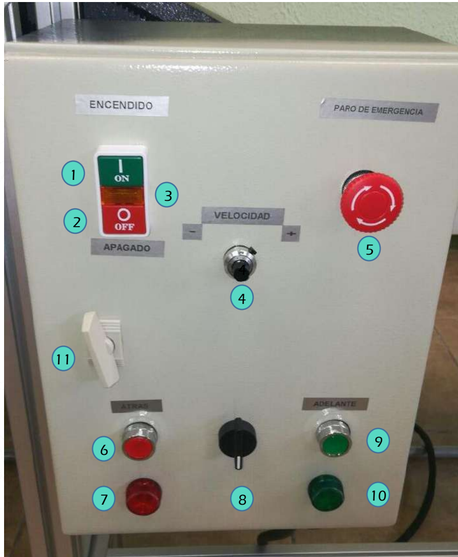
Fig. 83 Tablero de control de la estación de Cross Docking
