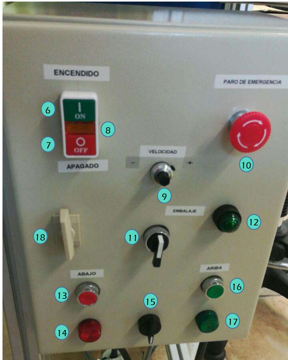
Fig. 91 Tablero de control de la embaladora automática
