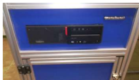
Fig. 45 Unidad de almacenamiento y procesamiento de datos
