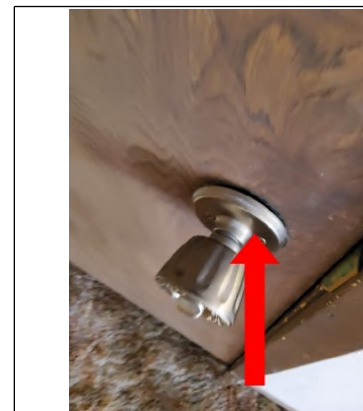
Loose door handle
