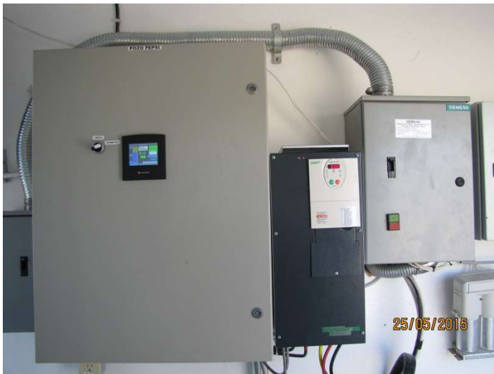
PANTALLA HMI SCADAGRAPH3000 CON VARIADOR DE VELOCIDAD EN POZO DE AGUA POTABLE
