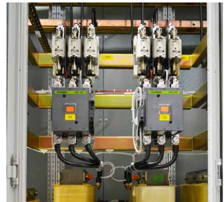
› Interruptor termomagnético gral. y apartarrayos
