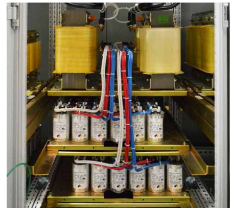
› Disposición de reactores en filtro automático
