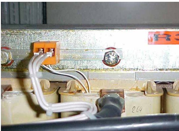
› Sensor de temperatura en el reactor
