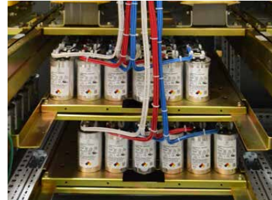
› Arreglo de celdas capacitivas en filtro
