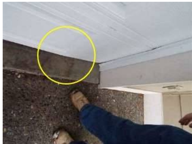
Photo 22-2 Garage door bent
