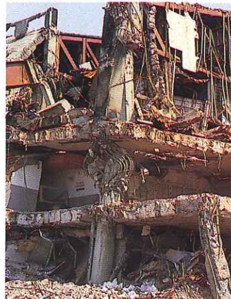
Una persona hubiese encontrado suficiente espacio para salir andando de esta estructura, de haberse protegido en ella de los posibles objetos a caer. Esto, a pesar de la severidad de los daños ocasionados por el terremoto.
