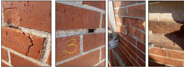
TYPICAL MASONRY DAMAGE PHOTOS SCALE: N.T.S.
