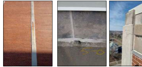
TYPICAL CONCRETE DAMAGE PHOTOS SCALE: N.T.S.
