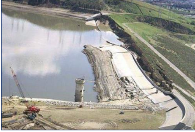
Şekil 2. Sıkılařma dolayısıyla zeminde meydana gelen oturma sebebiyle 1971 San Fernando depreminin etkisiyle zarar gören San Fernando barajı
