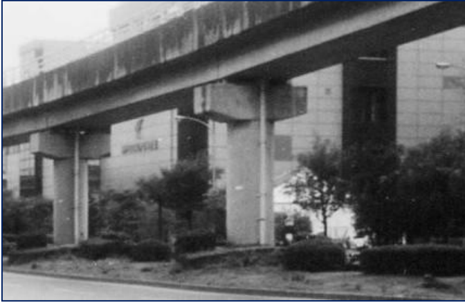
Şekil 3.Kobe Liman Adası'ndaki köprü ayaklarında oturma (1995 Hyogo-ken Nambu Depremi) (Tsukamoto ve Ishihara, 2010)
