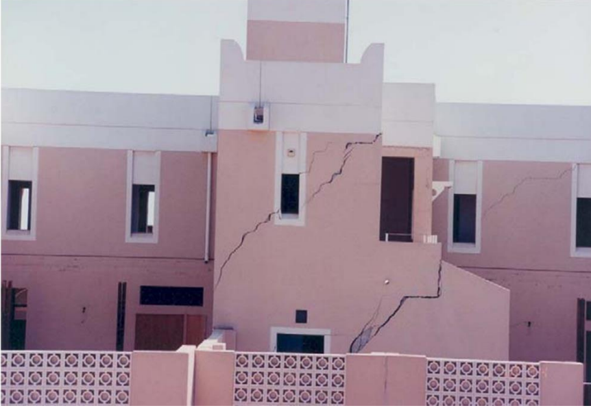
Şekil 1 Zemin kabarması nedeniyle oluşan yapısal hasarlar
