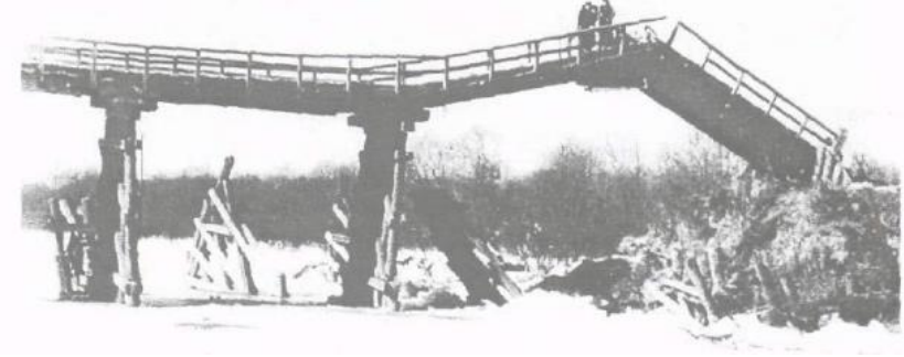
Şekil 2. Alaska (1964) depreminde sivilaşma sonucu köprüde oluşan hasar (Kramer, 1996).
