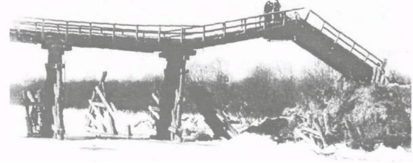
Şekil 2. Alaska (1964) depreminde sıvılaşma sonucu köprüde oluşan hasar (Kramer, 1996).
