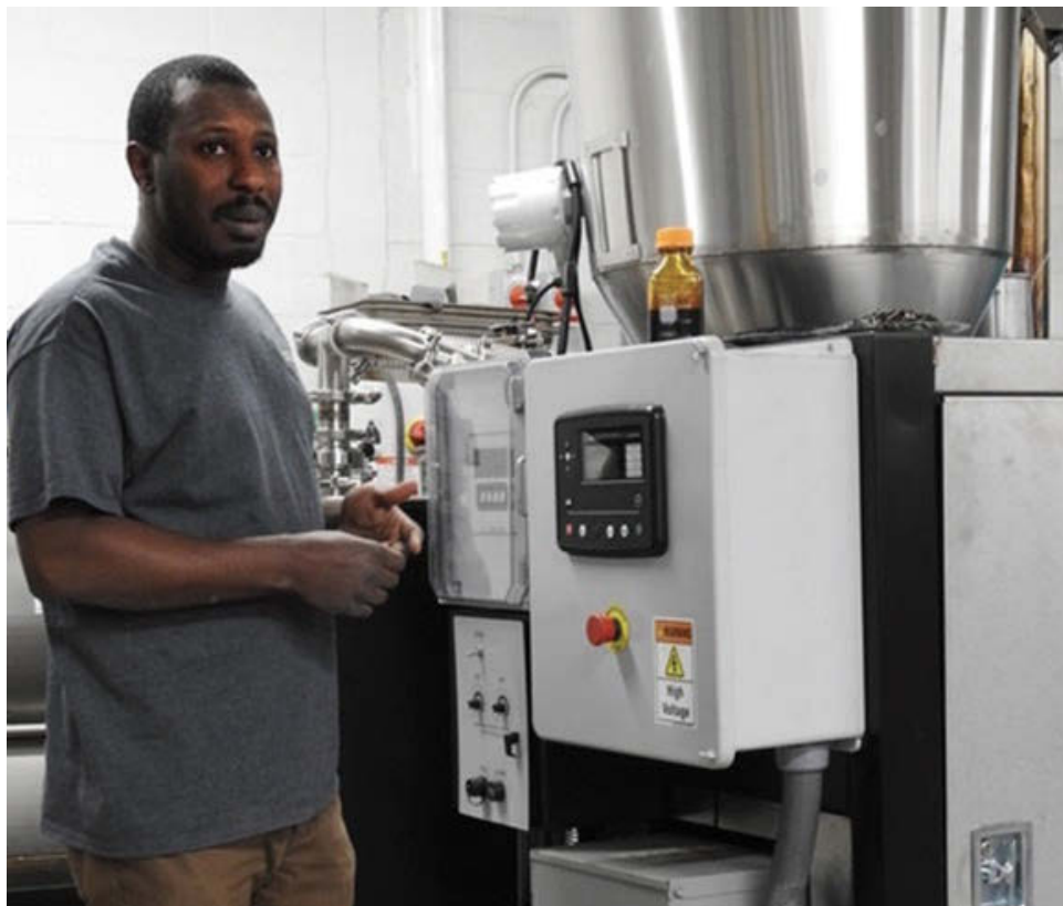
Papa Niokhor Diouf, codirecteur général Recherche et Innovation du SEREX, devant l'unité de gazéification qui permet d'alimenter une génératrice qui fournit de l'électricité.
