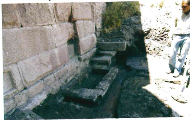
K1, K2, K3 kemerlerinin üzerindeki betonun sökümü sırasında yapının orijinal kısımlarına korumak amacıyla ahşap iskele yapıldı.
