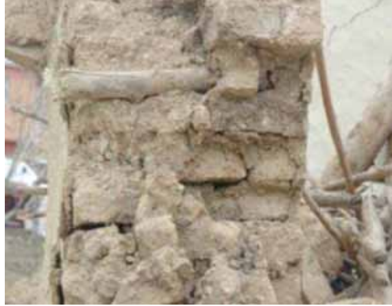
Şekil 14. Elazığ depremi, 8 mart 2010, hasar gören duvar ve döşeme türleri.
