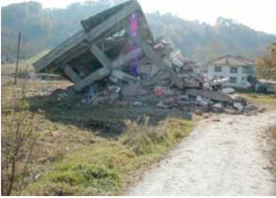
Şekil 17. İzmit Depremi 1999 hasarları: tuğla yığma 15 , hımsı 16 , betonarme iskelet 17 .
