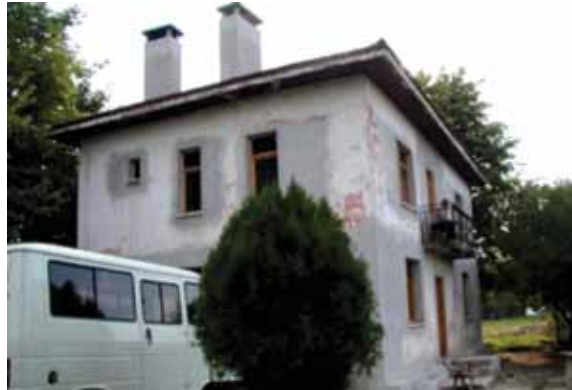
Şekil 15. İzmit Depremi 1999 hasarları: tuğla yığma 15 , himiş 16 , betonarme iskelet 17 .
