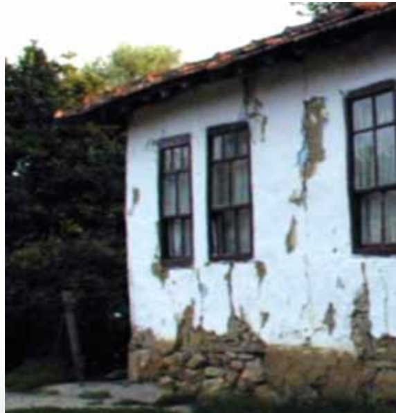
Şekil 16. İzmit Depremi 1999 hasarları: tuğla yığma 15 , himiş 16 , betonarme iskelet 17 .
