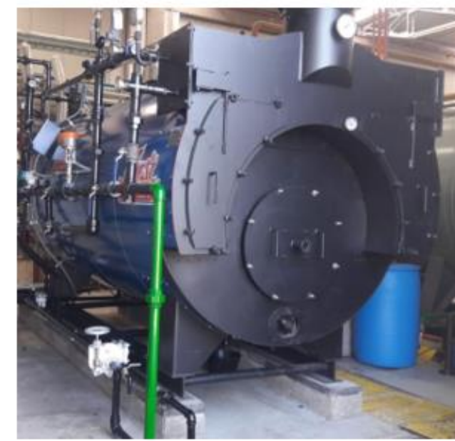
Belcorp Economizador integrado Caldera 200 BHP
