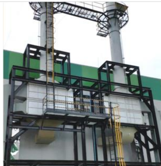
Central Cervecera de Colombia Precalentador de Aire Caldera 1500 BHP (2 units)
