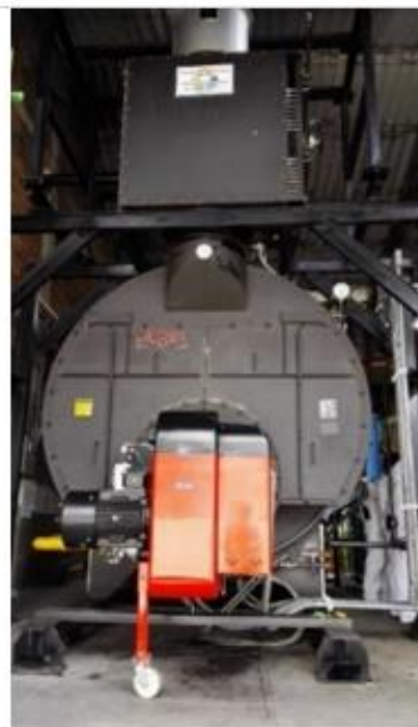
Colanta (San Pedro de los Milagros) Economizador externo Caldera 600 BHP
