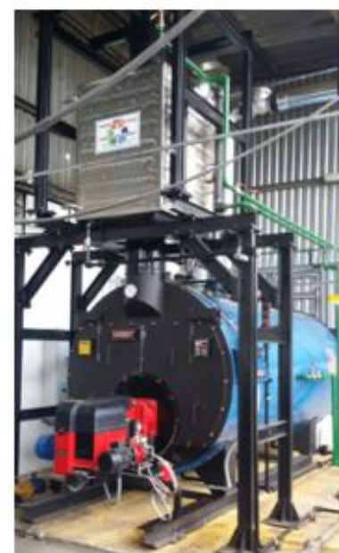
Colanta (Valledupar) Economizador externo Caldera 200 BHP
