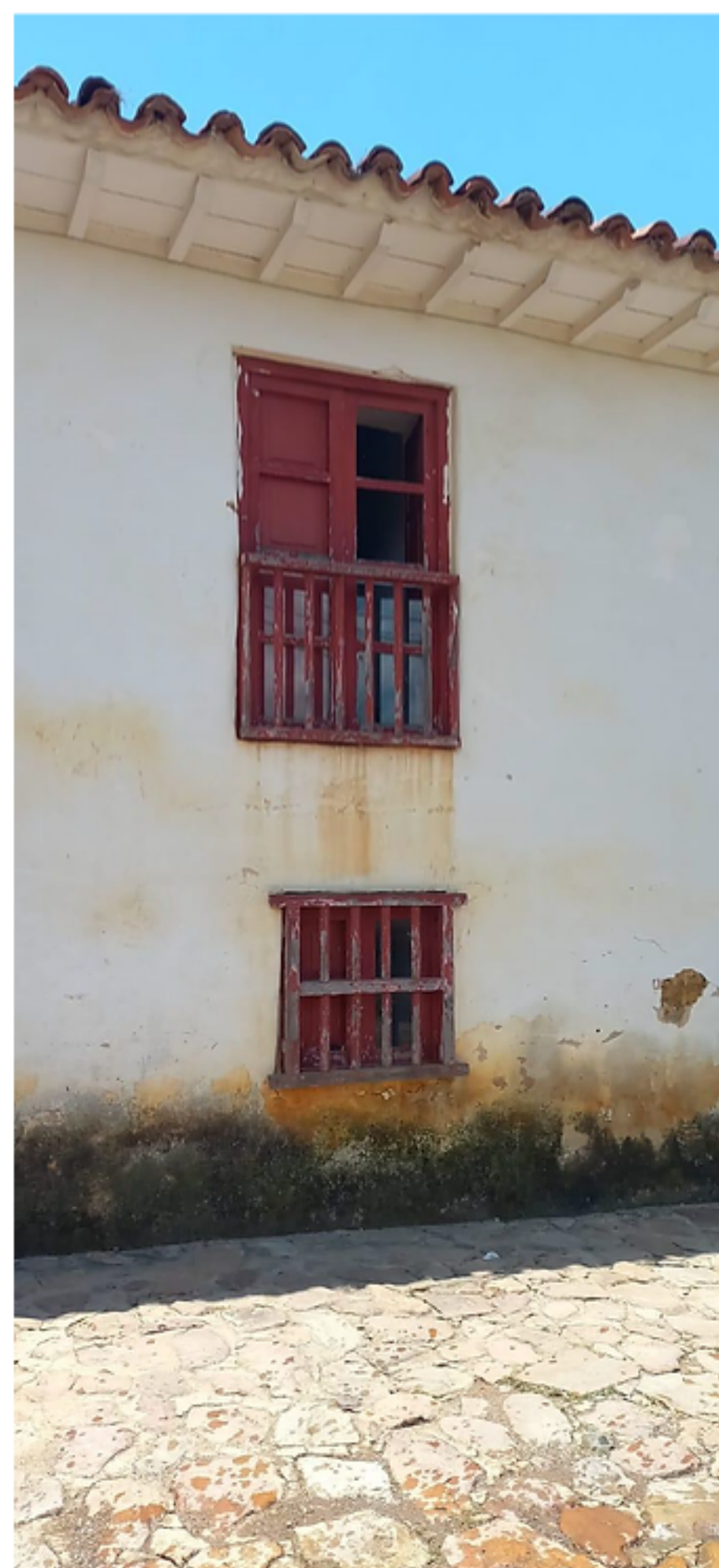
Fachada lateral del Claustro de San Francisco. El deterioro es lamentable
