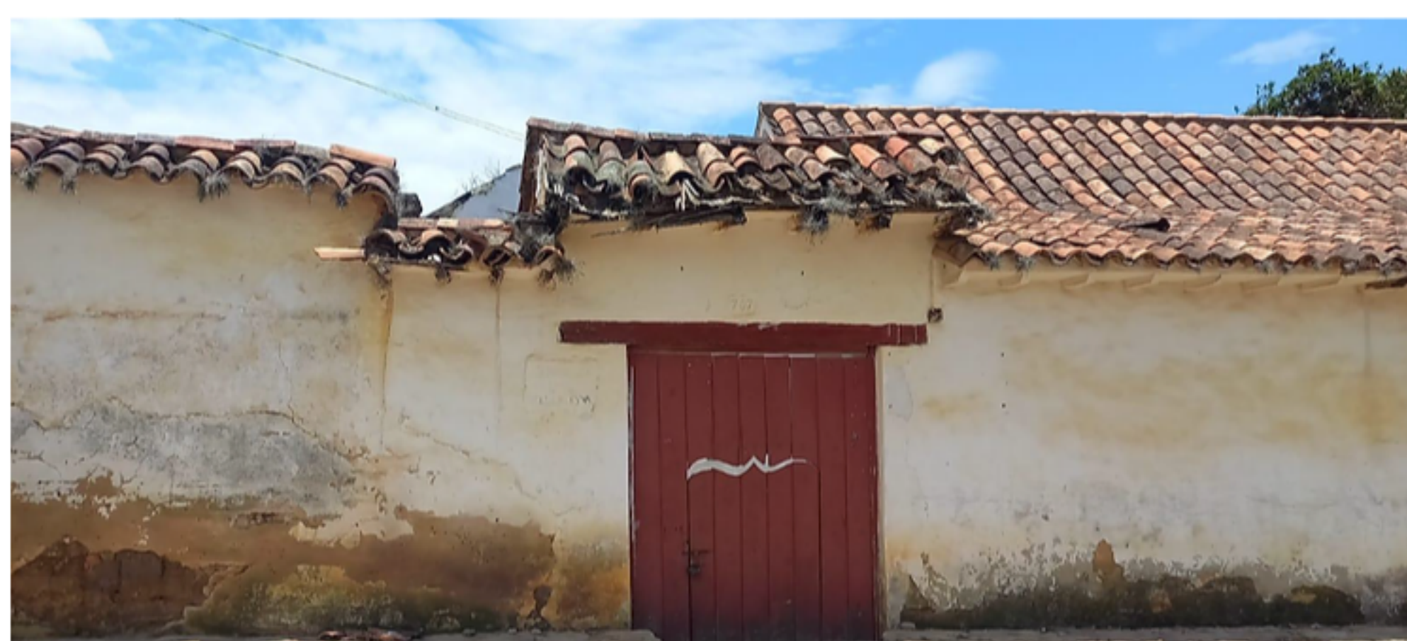
En el Claustro funciona la Biblioteca Municipal Camilo Torres y oficinas de Esvilla. El deterioro del monumento es preocupante.
