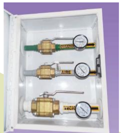
Caja de Valvulas
