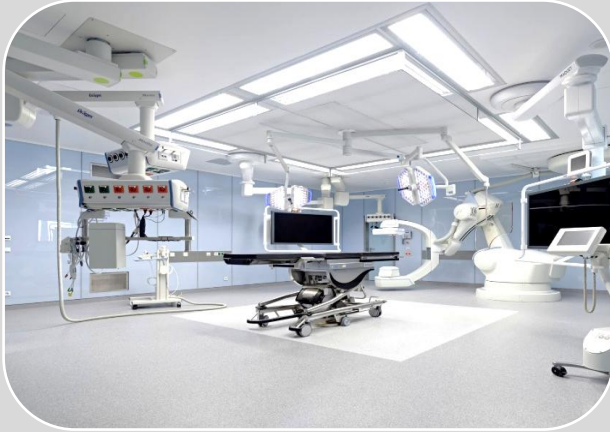
Sistemas de Quirófanos
