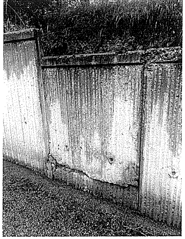
Foto-6: İstinat duvarı gövdesinde betonda çatlak ve dökülmeler, açığa çıkan donatılarda korozyon
