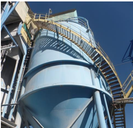
Silo de almacenamiento de cal viva
