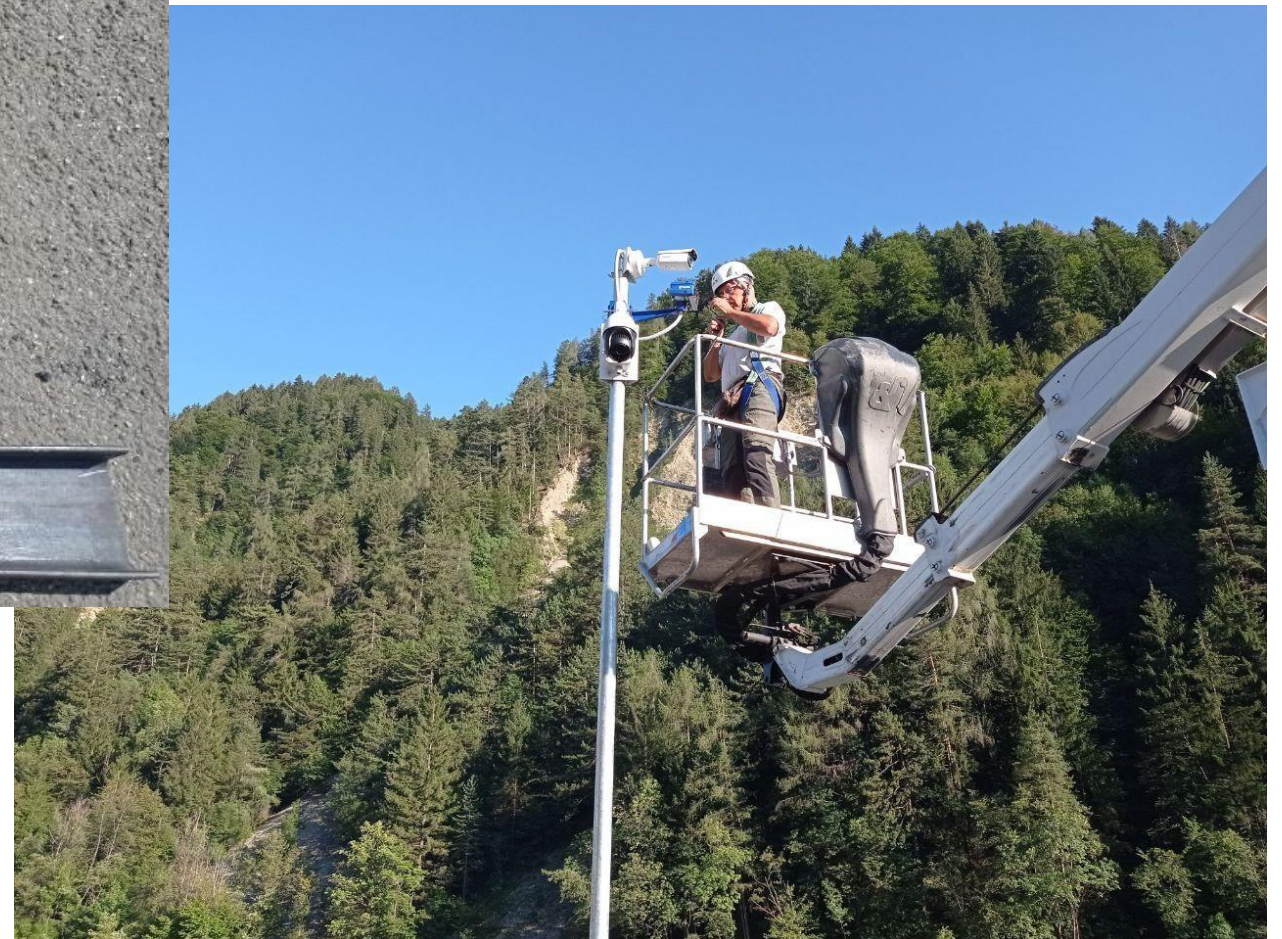
Figura 9: Instalación de cámaras LPR
