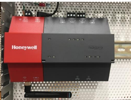
Photo 2 - Honeywell WEB-8000 JACE
