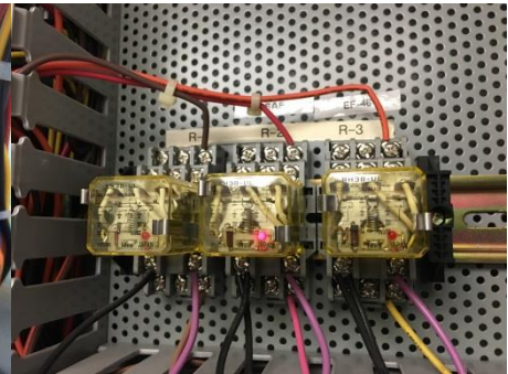
Photo 55 - Air-Handling Fan and Exhaust Fan Enable Relays
