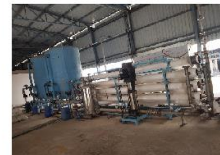
UF / RO SKIDS & PIPING
