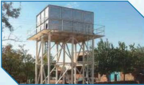
Diyarbakır DİSKİ Su Deposu (TÜRKİYE) - 30 ton Diyarbakır DİSKİ Water Tank (TURKEY) - 30 ton
