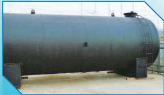
Meteoroloji Genel Müd. Radar İstasyonu Yakıt Tankı (ANTALYA) - 30 ton General Directorate of Meteorology Radar Station Fuel Tank (ANTALYA) - 30 ton
