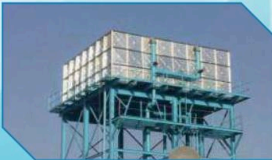
Kerkük / Yangın Su Deposu (İRAK) - 305 ton Kirkuk / Fire Water Tank (İRAK) - 305 ton
