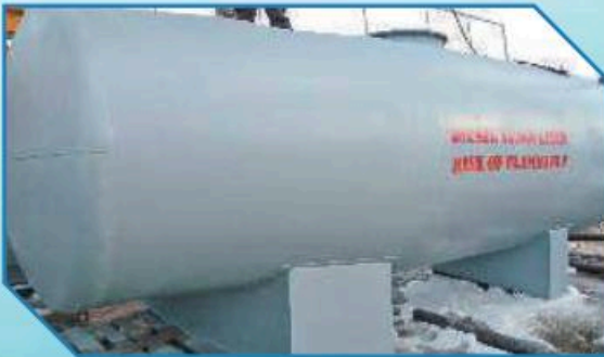
Bağdat Petrol İstasyonu Yakıt Tankı (İRAK) - 20 ton Baghdad Petrol Station Fuel Tank (IRAQ) - 20 ton
