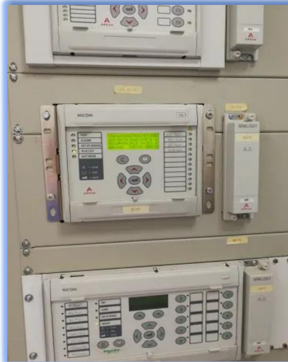
PUESTA EN MARCHA EN UPGRADE DE RELES DE PROTECCION
