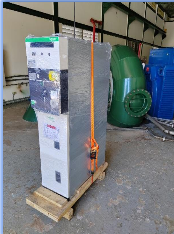
SUMINISTRO CELDA EN SF6 DE SALIDA IM, HIDRO PLANETAS DOLEGA, CHIRIQUI
