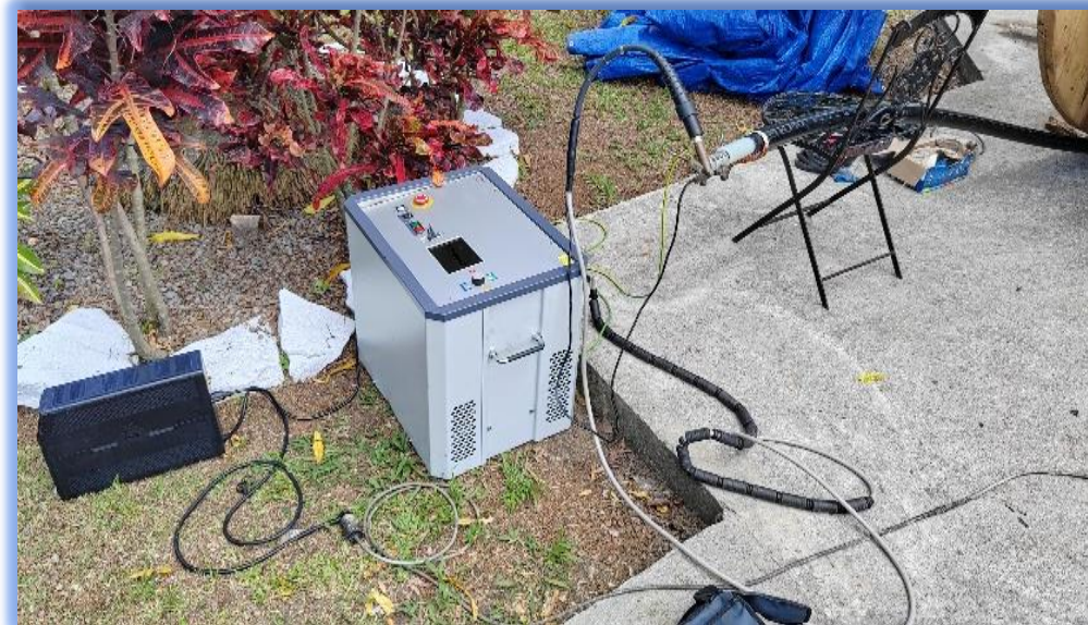
PRUEBA VLF MEGGER SINUS, CABLE 750MCM 35KV, AZUCARERA LE, PANAMA
